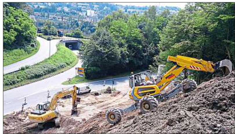
Nach der Flut 2013 wurde die Schadstelle bei Stelzlhof saniert. Doch bei Starkregen ist der Hang nach wie vor gefährdet. – Foto: Schoyerer
